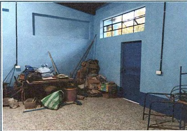
Foto 1: Mejoramiento de bodega finalizado, al fondo se visualiza esta puerta, que por las divisiones no se veía.
